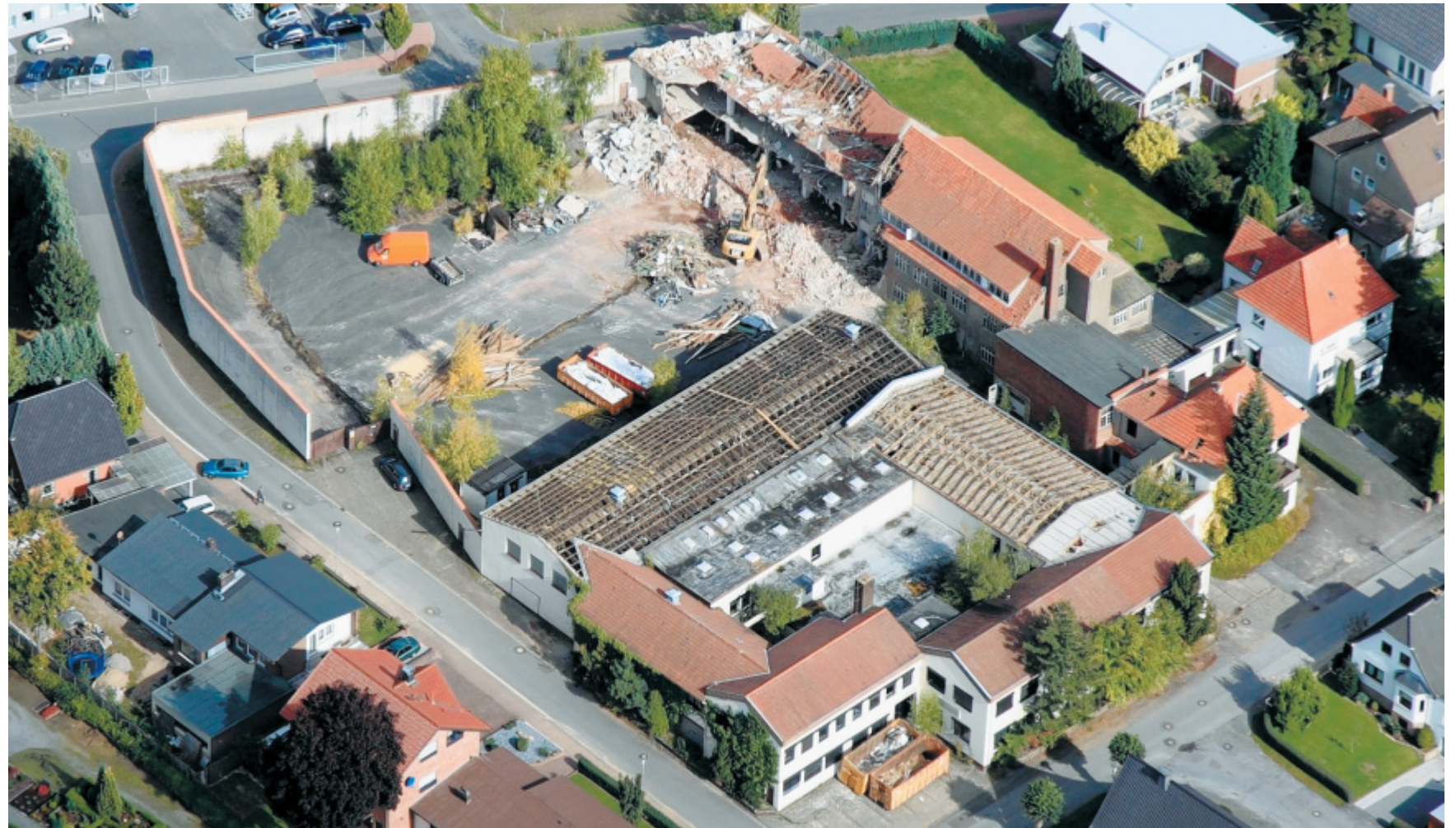
Mitten im Wohngebiet: Seit 1992 steht die Industriehalle der ehemaligen Chemiefirma ICI Pretechnik leer. Seit gestern laufen die Abrissarbeiten auf dem mehr als 9.000 Quadratmeter großem Gelände auf Hochtouren. Das Areal wird begrenzt durch die Straßen Am Kreuzkamp (oberer Bildrand), In der Gehle (links) und Postweg (unten). FOTO: EDWIN DODD
