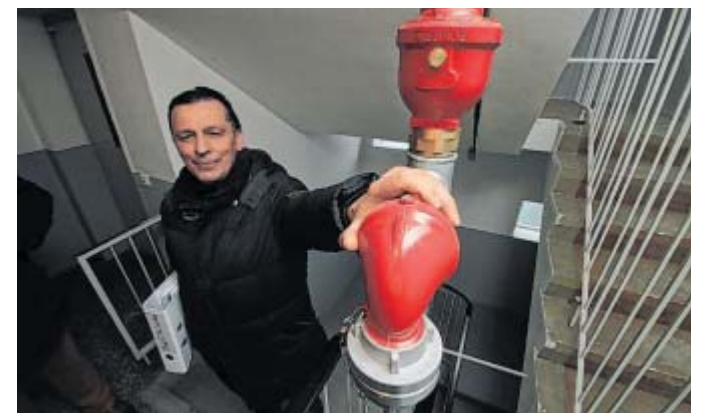
Verdoppelt : Durch beide Treppenhäuser verlaufen jetzt Löschwasser-Rohre, wie Immobilien-Sachverständiger Marco Tenge sie zeigt.
