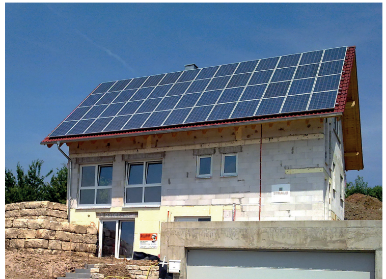
Photovoltaikanlage für das Eigenheim
