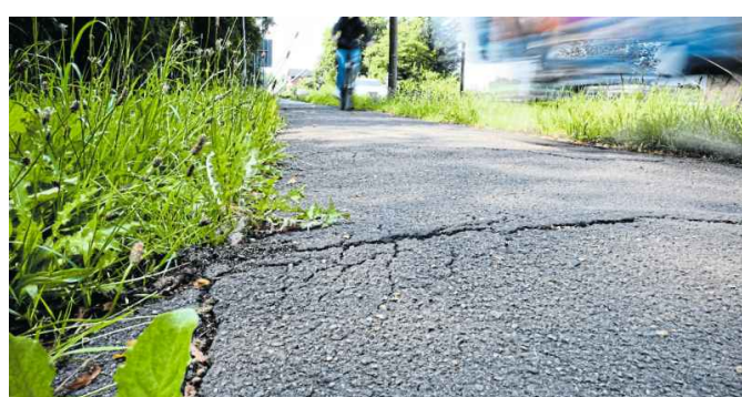
Tiefe Risse und Bodenwellen machen Radfahrern an der Bündler Straße schwer zu schaffen. Jetzt wird der Radweg saniert. Foto: Felix Eisele
